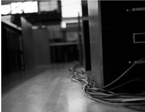
Figura 2.2. Instal·lació elèctrica provisional amb l'escomesa elèctrica amb una protecció deficient
